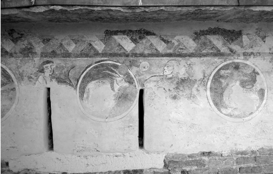
Fig. 13 - Lacerti di affreschi della fascia al di sotto della merlatura di Palazzo dei Trecento
