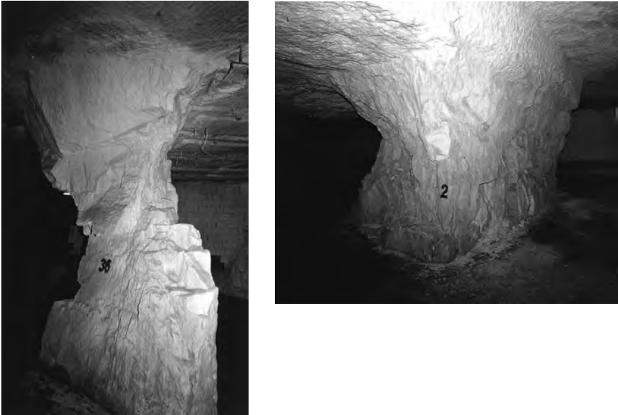
Figura 9 – Pilastri tipici tra quelli riparati nel “Covolo della Guerra” di Costozza di Longare.
